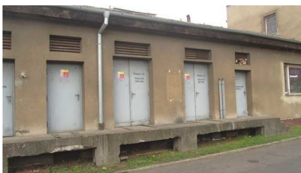
Obrázek č.5: Trafostanice
